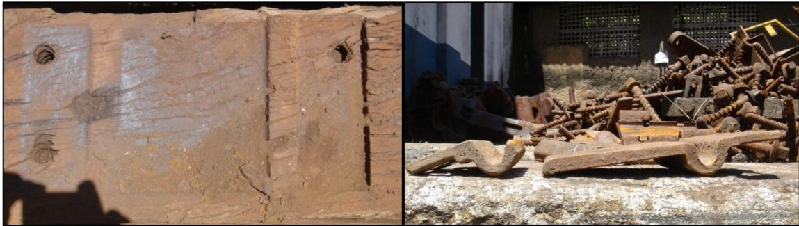
Figura 82: Placa de apoio cortando o dormente e placas de apoio fraturadas devido à alta força lateral.
