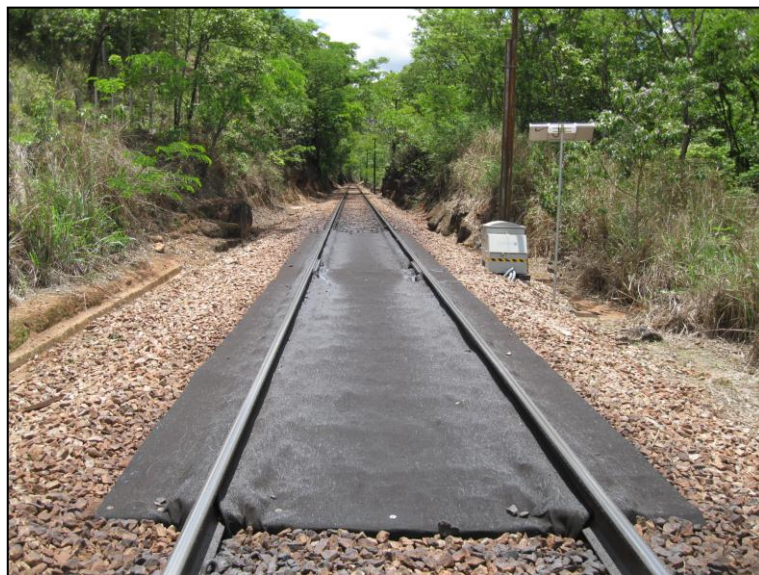
Figura 106: Instalação típica do lubrificador ao lado da via na MRS Logística.
