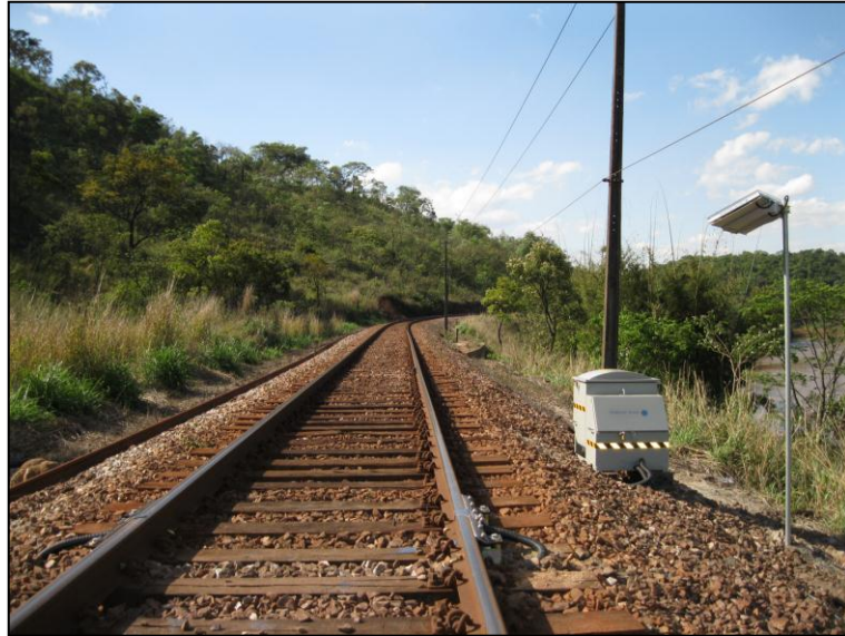
Figura 122: Instalação típica do aplicador TOR ao lado da via na MRS Logística.
