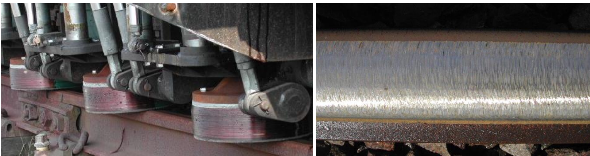
Figura 135: Rebolos de esmerilhamento a esquerda e aspecto do trilho esmerilhado a direita. (SROBA P. , 2012)
